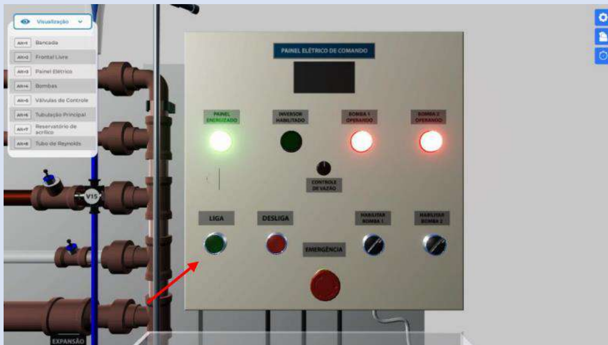
Figura 7 – Ligação do painel elétrico
